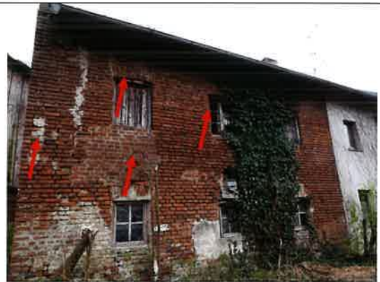
Abbildung 14: Potenzielle Quartiermöglichkeiten an Gebäuden (Auswahl)
